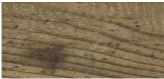
Stockflecken und leichter Schimmelbefall
