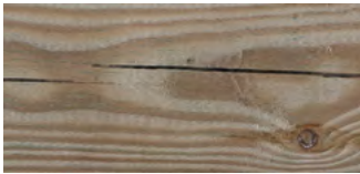
Spannungsrisse durch die Holz-trocknung
